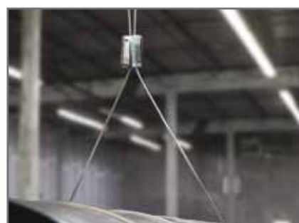
Gaine de ventilation circulaire
