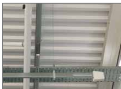
Canalisation électrique préfabriquée
