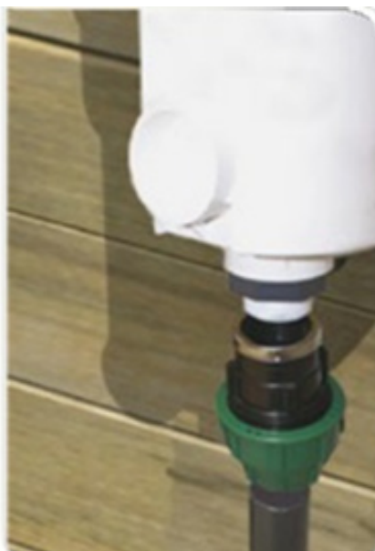
Descente rigide sous skimmer
