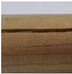
Cracks/Grietas/Fente/Risse/ Crepe/ Barsten/Fendas
